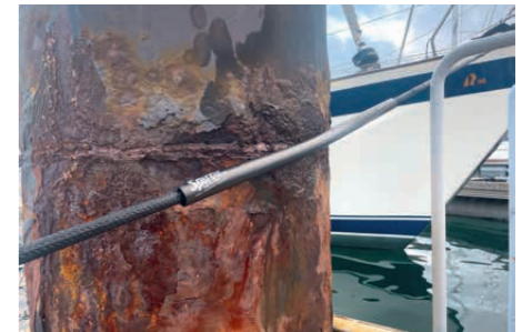
Die rostige Oberfläche dieses Pollers würde eine Leine ohne Schutz schnell durchscheuern
